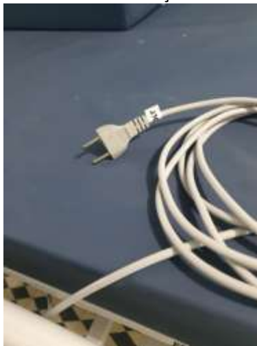
Imagem 01: cabo de alimentação sem aterramento.
